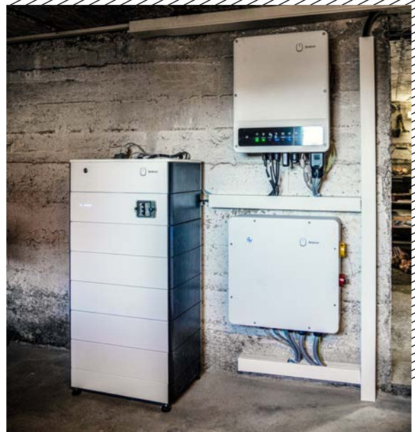
Das Herzstück der PV-Anlage steht im Keller: Energiemanagement, Wechselrichter und Batteriespeicher mit Notstromfähigkeit von FENECON, dem daheim-Solar-Partner.
